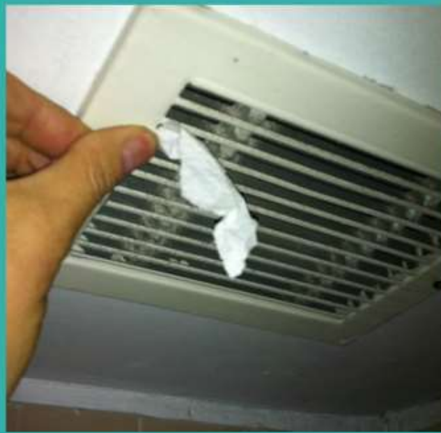
Presión invertida (extracción de baños)
