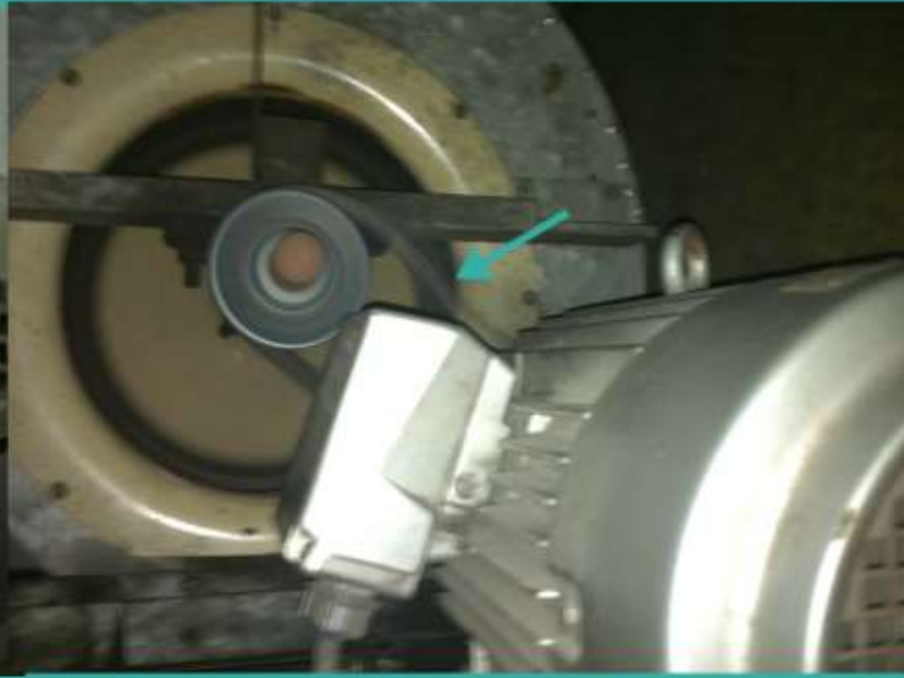
Polea suelta del ventilador (bajo caudal de aire)
